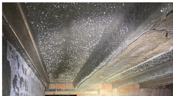
Condens op het plafond van de kruipruimte
