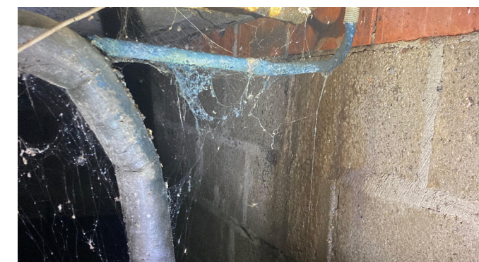
Leidingen die lekken
